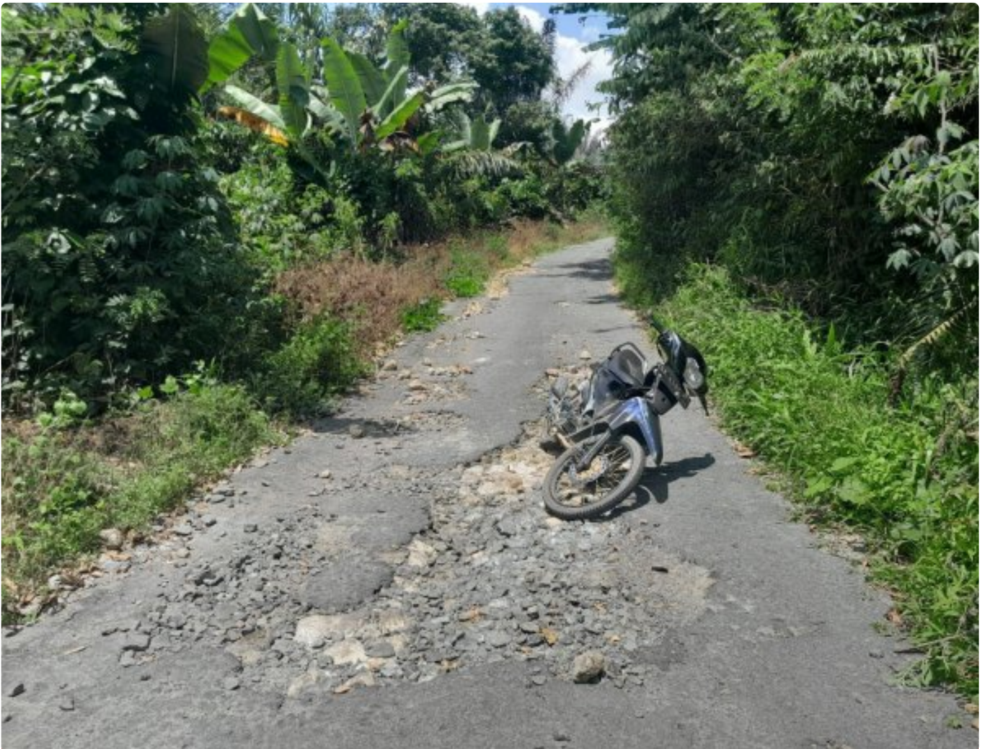
Ruas jalan jurusan Kandang Lombu-Hutaurung, Nagori Panombean Hutaurung, Kecamatan Jorlanghataran, Kabupaten Simalungun sudah rusak
